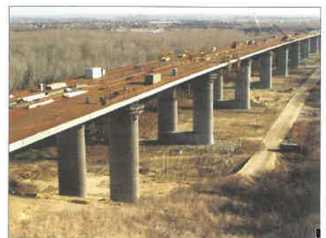
10. ábra A jobb parti ártéri hidak építésének állása 2007. január utolsó napjaiban
