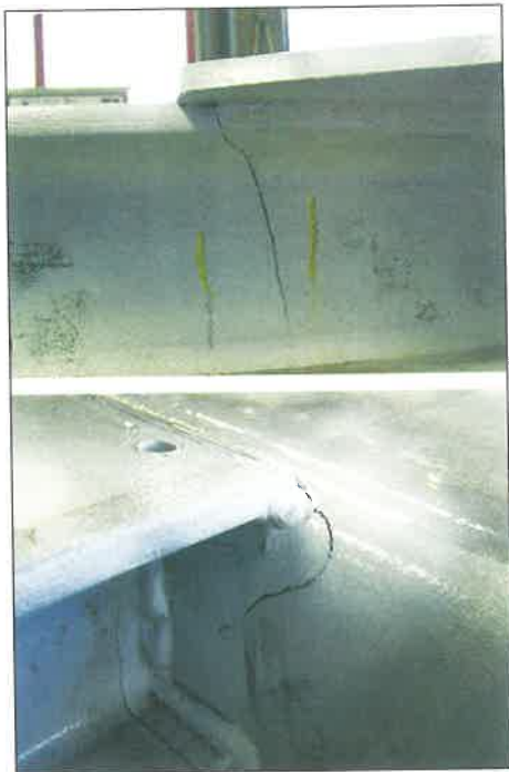
9. ábra. Galvanizáláskor keletkező repedések egy 6 mm vastag járművázban, amelyet S 690M termomechanikus kezelésű nagyszilárdságú szerkezeti acélból készítettek
