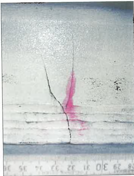
10. ábra. Rejtett galvanizálási repedések egy csomólemezzel szerelt tartó gerinclemezában a repedést mágneses repedésvizsgálat mutatta ki (lásd a 9. ábrát), a festékező folyadék penetrációs eljárással kimutatott repedési rés és a varratfémbe látható még hosszirányú repedésre utaló jel.
