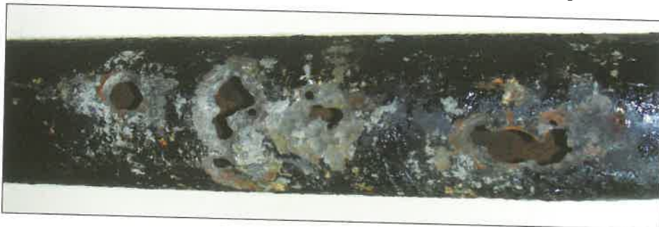
1. ábra Lyukadásos korrózió acél gázvezetéken
