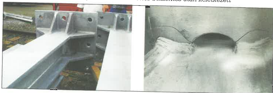
8. ábra. Szabad szemmel nem látható repedések a beépített merevítő betételemezeknél, ahol az alaplemez és a bonyolult profil közötti hirtelen vastagságváltozás „ugrás” miatt keresztmetszet változást van. A repedést a mágneses repedésvizsgálat tette láthatóvá
