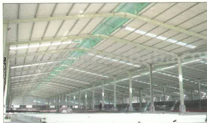
10. fotó Tűzvédelemmel ellátott acélkeret.
