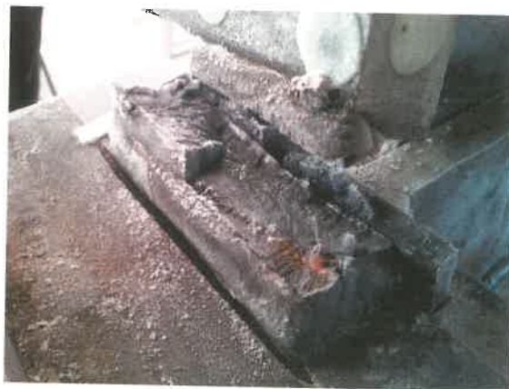
Az oszlop-gerenda kapcsolat törése a ciklikus terhelés során
