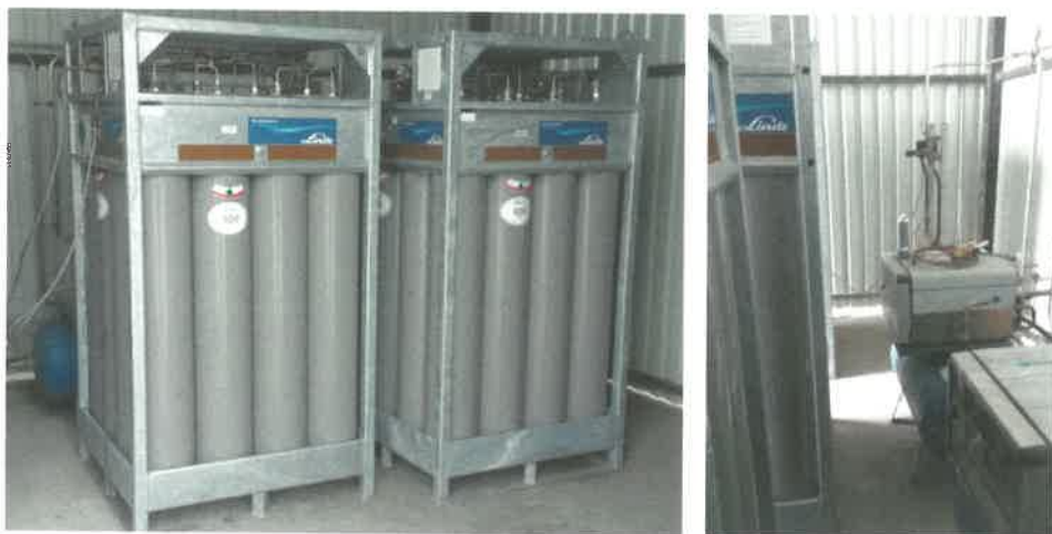
2. ábra. 300 bar töltetnyomású palackkötegek a hagyományos 200 bar-os lefejtő rendszeren keresztül biztosítják a Stadler Szolnok Vasúti Járműgyártó Kft hegesztési keverék védőgáz ellátásának hélium igényét
