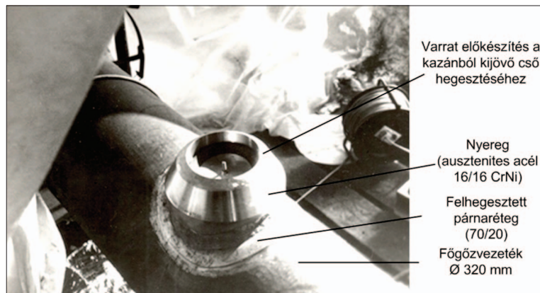
1. ábra. 14MoV6 3 minőségű főgőzvezeték és 16/16 típusú melegszilárd ausztenites cső kapcsolata. Üzemi hőmérséklet: 520°C, üzemi nyomás: 120 bar, üzemidő: 35.000 óra.
