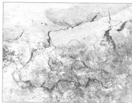
4. ábra. A cső belső felületén látható károsodások
