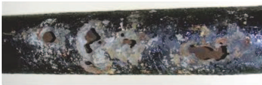
1. ábra Kóboráram korróziós hatása a szegedi gázhálózat acélcsővein [2]
